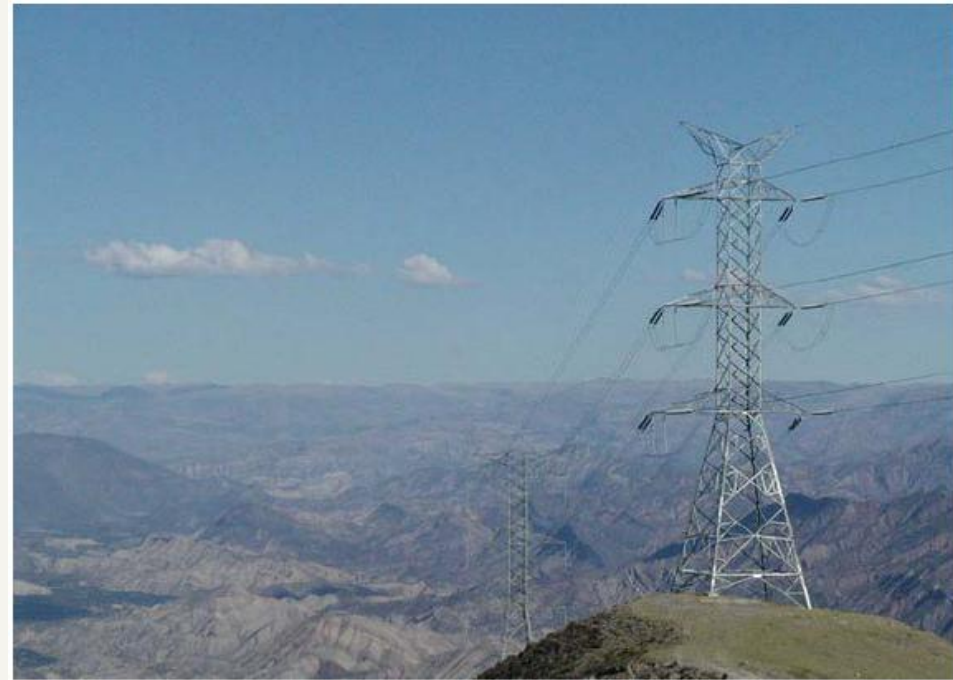
L.T. 220 kV Mantaro – Cotaruse: Sector Churcampa – Churcampa – Huancavelica.
