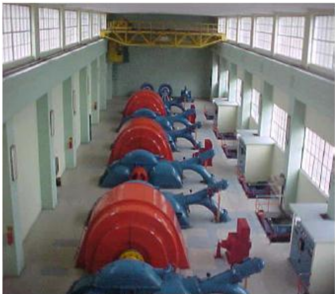
Sala de máquinas
