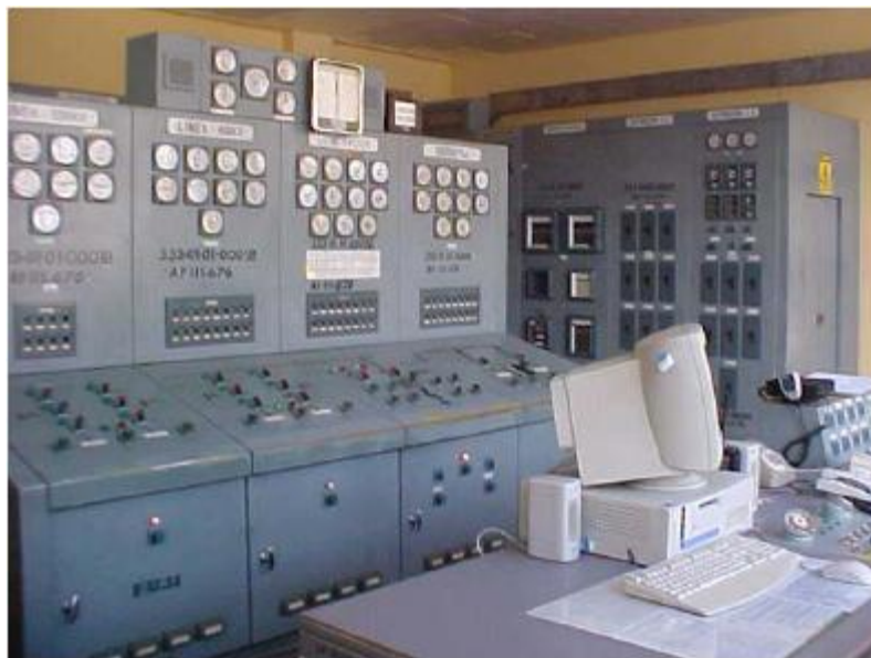
Sala de control - tableros
