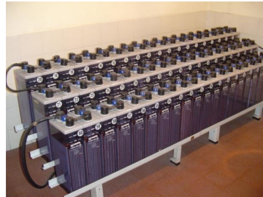
Banco de baterías 125 V DC
