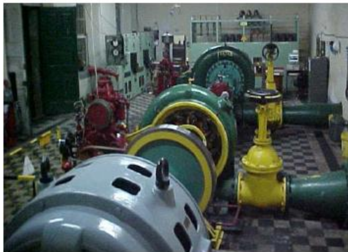
Sala de máquinas
