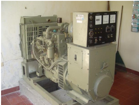
Planta de emergencia
